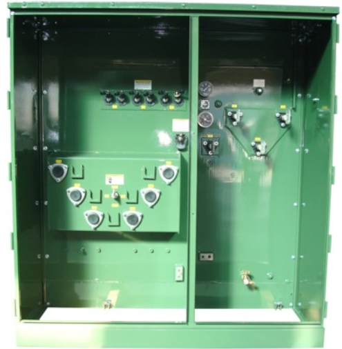
909180 AEC, Inc, 2500 KVA, 12470-480
